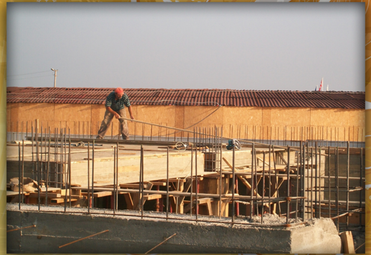
TABLIYE BETON KALIBI
